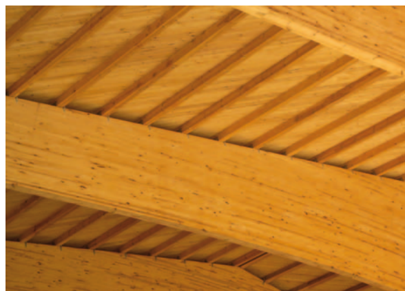
Abbildung 6: Brettschichtträger aus Kiefer (Foto: Klenk AG, Oberrot)
